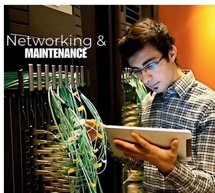
NETWORKING & STRUCTURED CABLING شبكات وأسلاك منظمة
